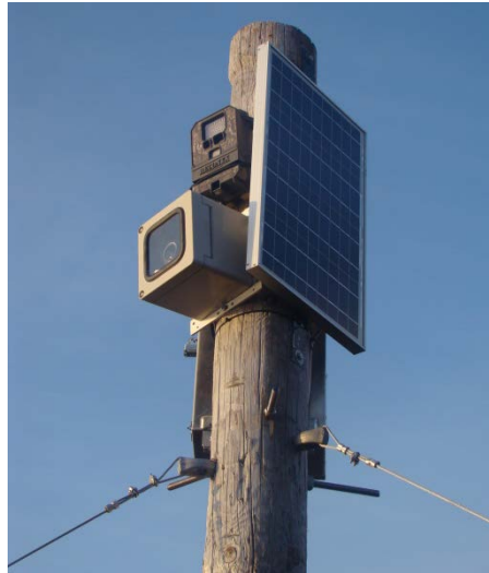
Figure 74 Exemple d'installation des caméras
