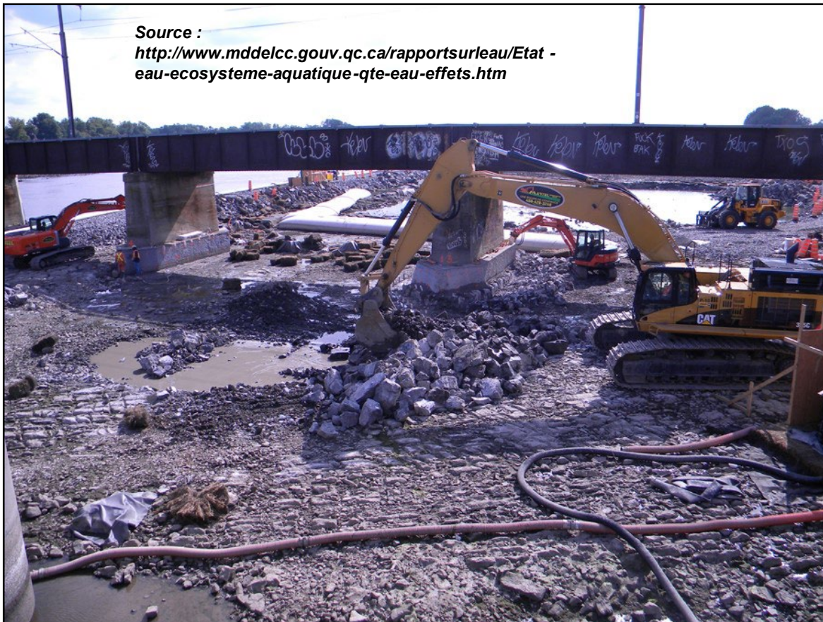
Figure 2.2 : Illustration des travaux d'écrêtage menés dans la rivière des Mille-Îles. Tirée de Poulin (2019)
