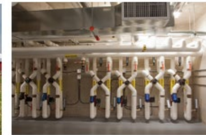
2 800 autres actifs divers (systèmes électriques, mécaniques, hydrauliques et de drainage)
