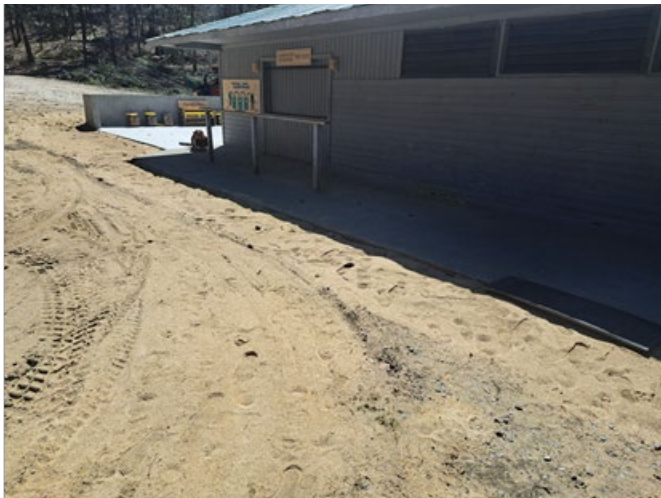
Figure 1 : cour où l'eau de pluie s'accumule.
